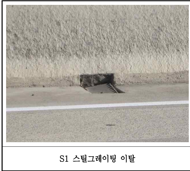
【사진 6.3.22】 배수시설 손상현황
