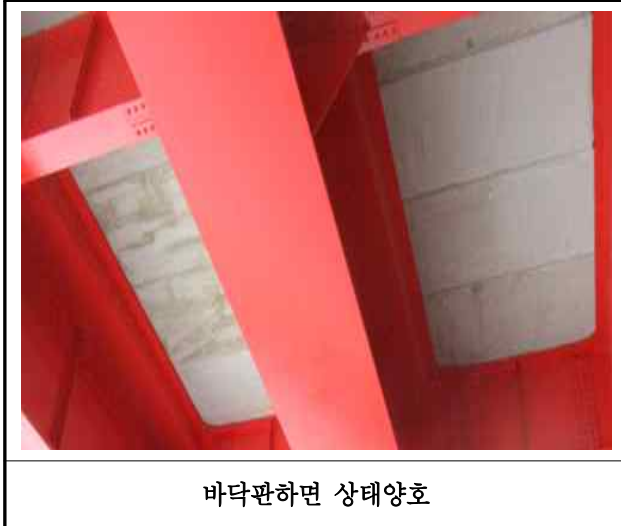
【사진 6.3.3】 바닥판하면 손상현황
