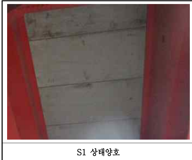
【사진 6.3.3】 바닥판하면 손상현황
