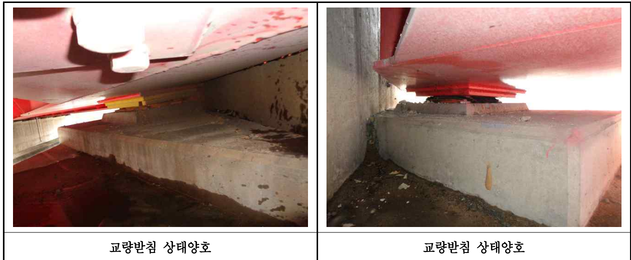
【사진 6.3.13】 교량받침 손상현황
