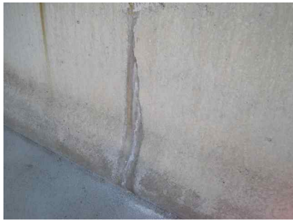
S1 균열부 백태 (0.1m x 1.5m)
