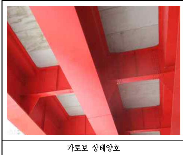
【사진 6.3.7】 가로보 손상현황
